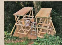
下段デッキに2×材で組んだ足場の台を2個置く。この上に乗って上段デッキを作る
