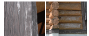
春が来て、雪が解けると、積雪による木部の傷みが判明する。外壁の下部には、湿度で劣化の兆候が見られる部位もある。そうした箇所をこまめにチェックして塗装し、傷みの進行を抑えている
