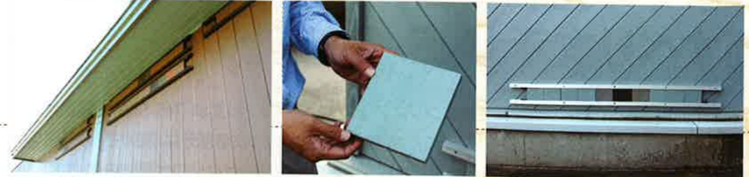
軒下やバルコニーの床近くなど雨掛りであることから傷みの見られた箇所にテストピースを取り付けるレールを設置し、曝露試験を実施する。テストピースは、張り替えて取り外した古いスギの外壁材を15cm角にカットし、含まれる防カビ剤や色の異なる「キシラデコールコンゾラン」を塗布した。半年に1度、クラックやカビの様子を目視や顕微鏡で観察する
