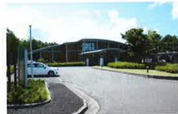
研究所本館の東面に当たる正面玄関。この面は、外壁、柱・梁、軒天、建具と、木部すべてを塗り替えた
