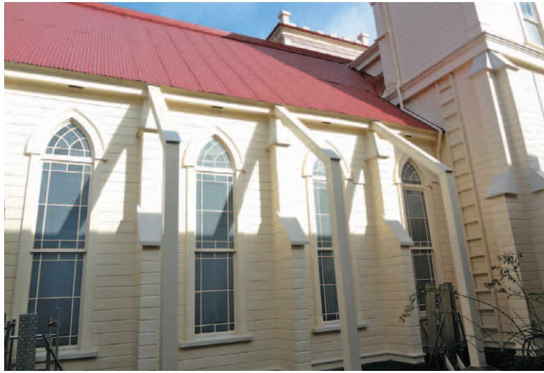
礼拝堂の外壁南面。旧塗膜を取り除き、下地を整えたうえで、高耐久性水性造膜型木材保護塗料「キシラデコールコンゾラン」に塗り替えた。色は、ライトアイボリー。2005年度に実施された前回の外壁改修工事で塗り替える前の色に戻した
