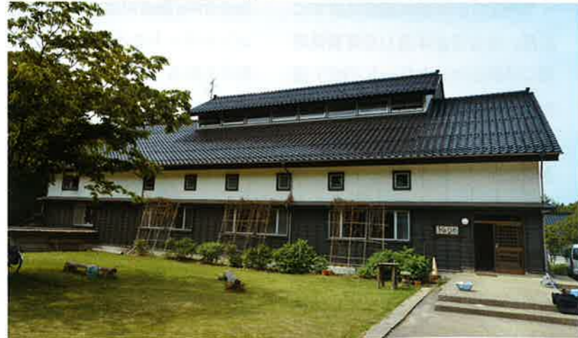
写真下は1988年に移築した本部棟、写真右上は92年に新築した稽古場棟。外壁の木部は当初、木材保護塗料のキシラデコールで仕上げた。その後、2004年に実施した塗り替えでは、キシラデコールコンゾランの前身にあたるコンゾランの「チョコレート」を用いた。10年近くたつものの、劣化は見られない
